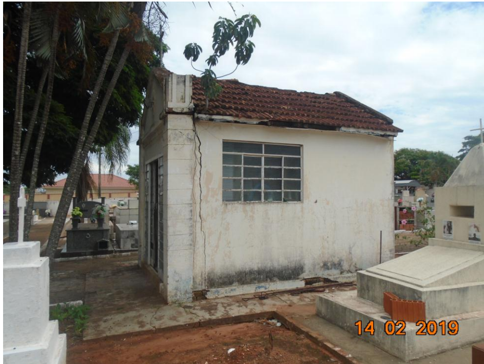
JANELAS A SEREM SUBSTITUÍDAS
