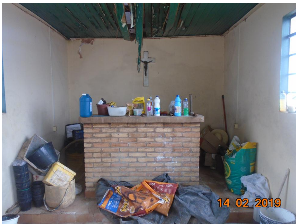
FORRO E TELHADO DANIFICADOS A SEREM SUBSTITUÍDOS
