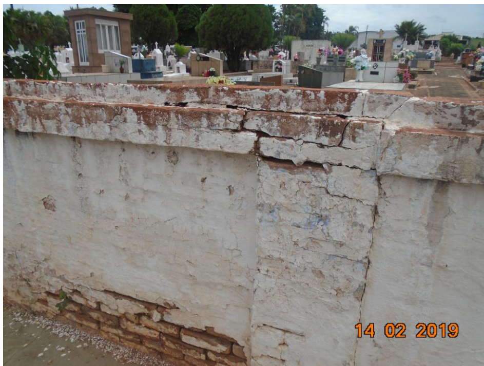
MURO DO CEMITÉRIO DANIFICADO, DEVERÁ SER REBOCADO E PINTADO
